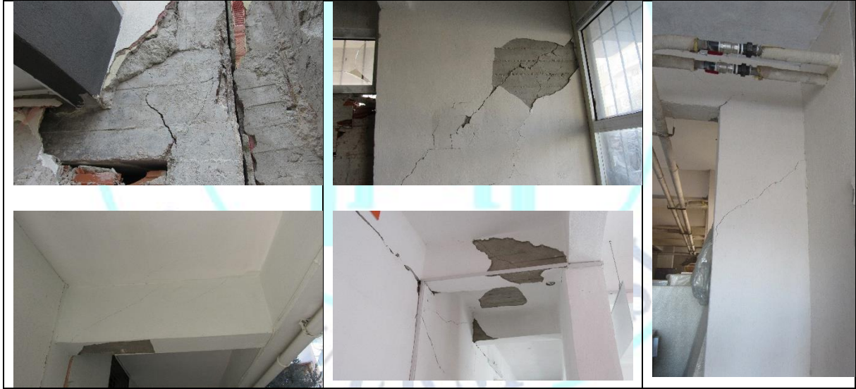
Şekil 6. Kesme Çatlağı Örnek Fotoğraflar
