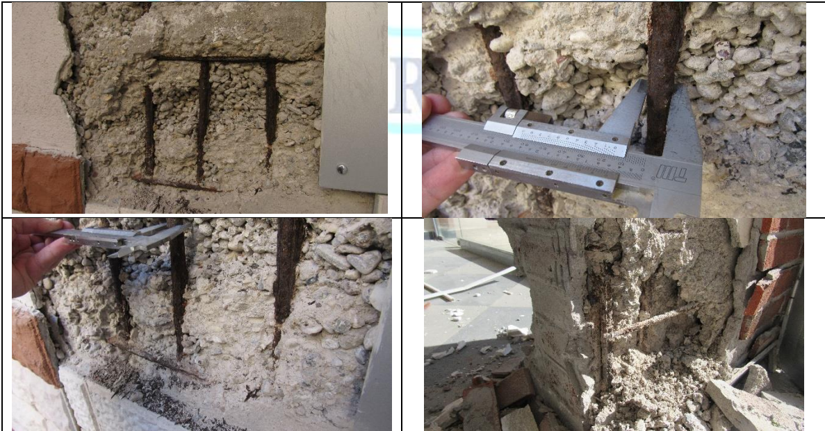
Şekil 8. Korozyon Örnek Fotoğraflar
